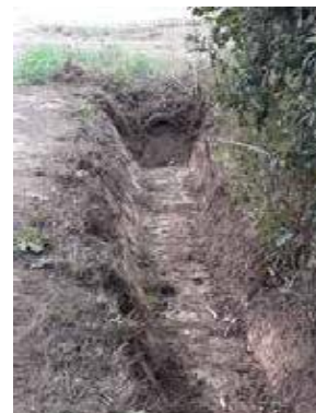
Buses qui devront être débouchées manuellement
